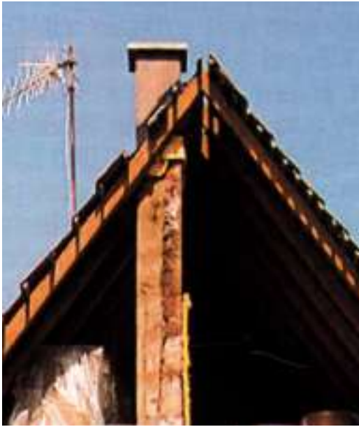
Abb. 13 Absturz eines nicht ausreichend gesicherten Giebeldreiecks
